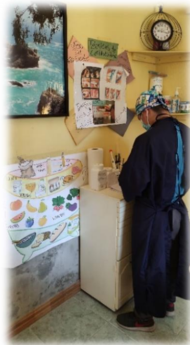
Situación inicial de humedad en paredes y repello suelto de pared en clínica dental.
