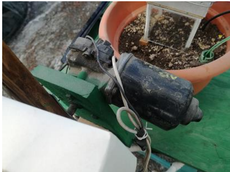
Figura 47. Actuador del seguidor solar en funcionamiento
