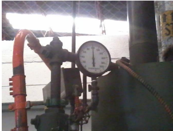
Figura 13. Caldera a 100 PSI
