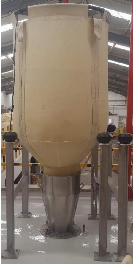
Figura 42. Big Bag colocado en línea de llenaje
