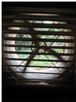
Imagen 1. Ventiladores con motor 1.7 HP 1.33Kw 3~
