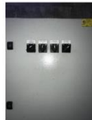
Imagen 29. Refrigeración, Calefacción y recirculación.
