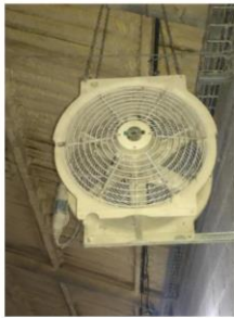
Imagen 7. Ventilador de recirculación
