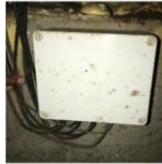
Imagen 3. Caja de registro
