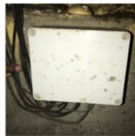
Imagen 3. Caja de registro
