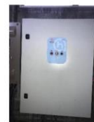
Imagen 30. Control de alarmas.
