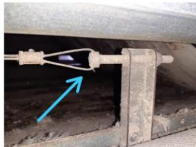
Imagen 29. Final de cable.
