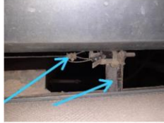
Imagen 8. Bornes de conexión y cable de distribución por línea.
