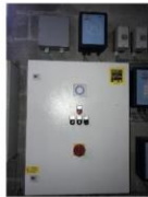
Imagen 36. Alimento 38. Control de alarmas.
