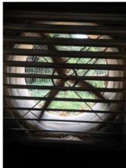
Imagen 1. Ventiladores con motor 1.7 HP 1.33Kw 3~
