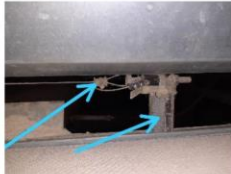
Imagen 27. Borne de conexión y cable de distribución por línea.
