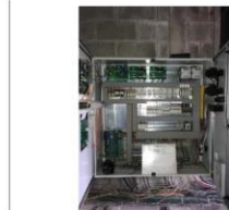
Imagen 25. Interior paneles de control
