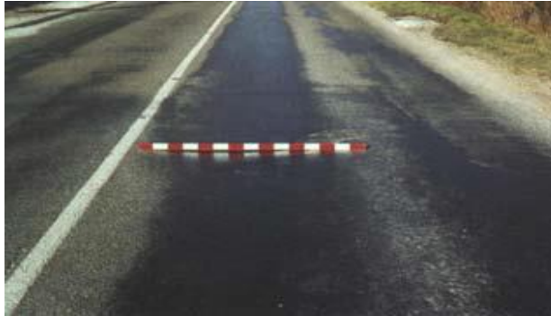
Figura 5. Exudación de asfalto
