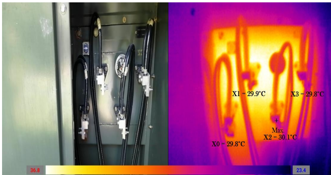
Figura 22. Termografía en bornes secundarios del transformador
