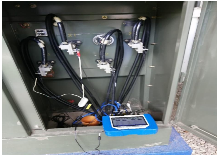
Figura 26. Conexión de Dranetz HDPQ Guide al punto de medición
