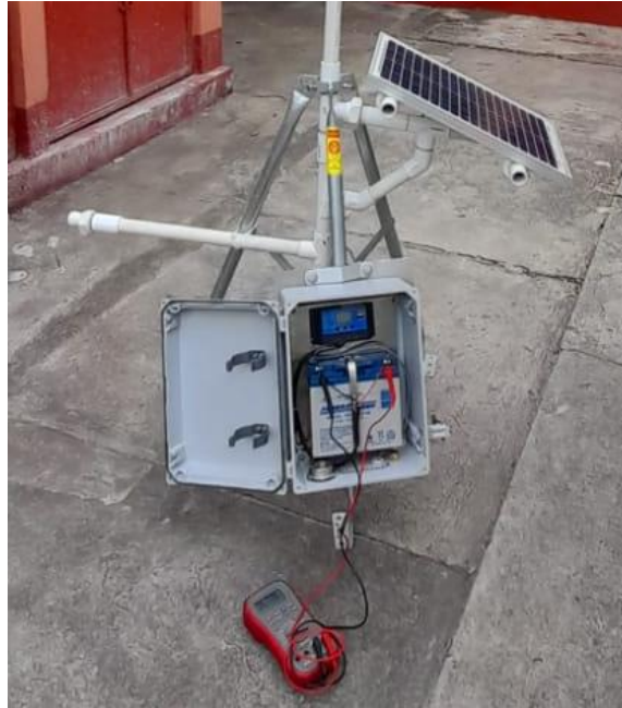
Figura 129. Implementación caja NEMA 4
