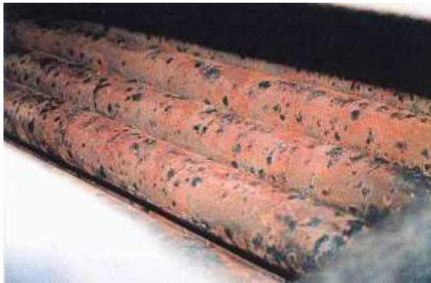
Figura 9. Corrosión por oxígeno
