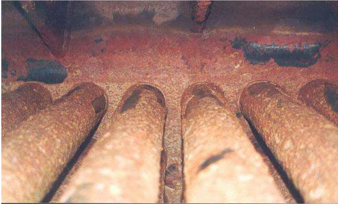
Figura 11. Incrustaciones en tubos de humo
