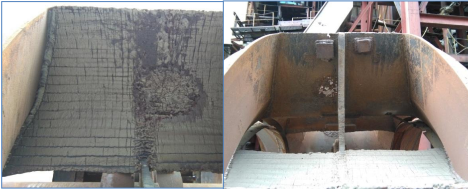
Figura 13. Daño de ventilador tiro inducido al finalizar la zafra.
