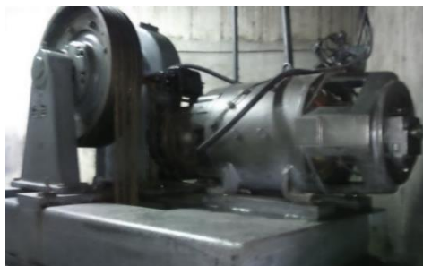
Figura 39. Motor eléctrico elevador uno
