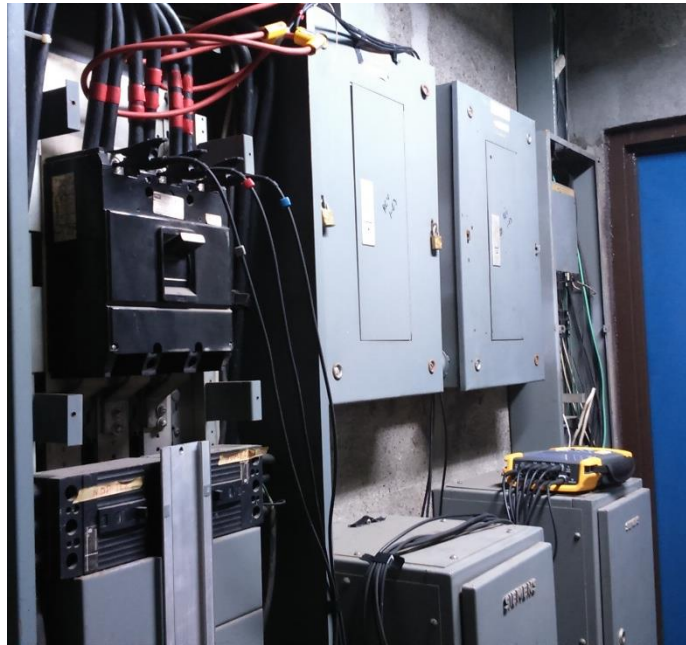
Figura 30. Analizador de red conectado a tablero principal CDPE T2
