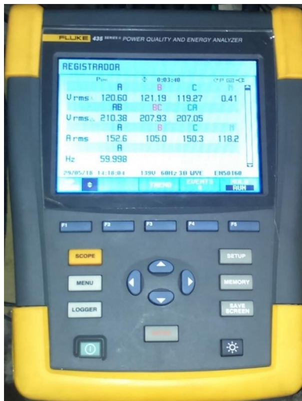
Figura 25. Analizador de red
