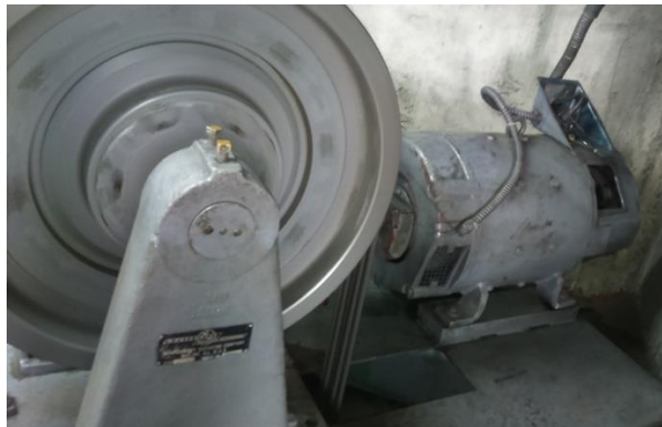
Figura 42. Motor eléctrico elevador siete
