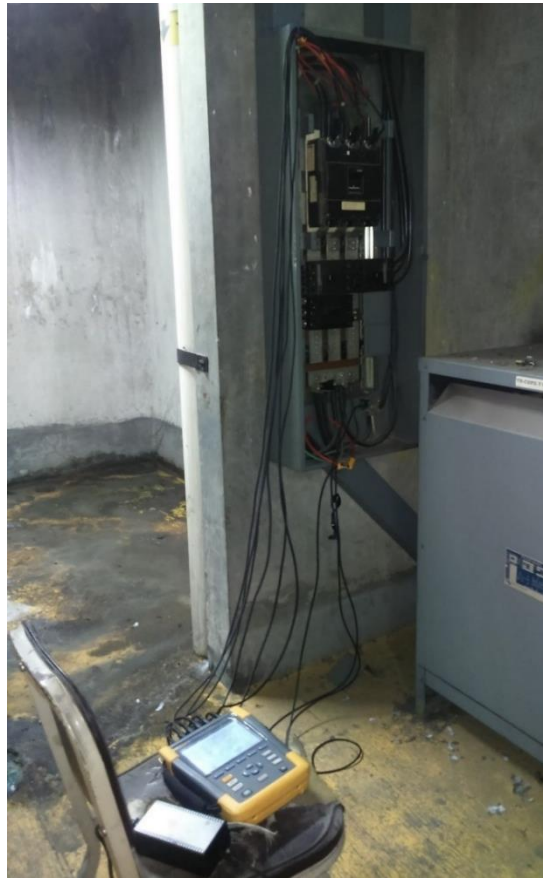
Figura 27. Analizador de red conectado a tablero principal CDPE T1
