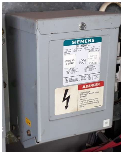
Figura 102. Transformador seco SIEMENS 0.5KVA
