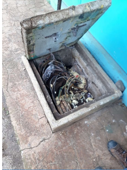
Figura 68. Caja de registro en cuarto de iluminación 3
