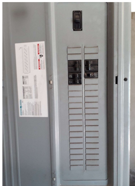
Figura 49. Centro de carga 2
