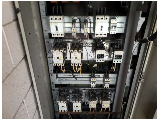
Figura 59. Protecciones y contactores en cuarto eléctrico de iluminación 1
