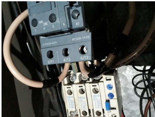
Figura 53. Contactores en módulo de control principal
