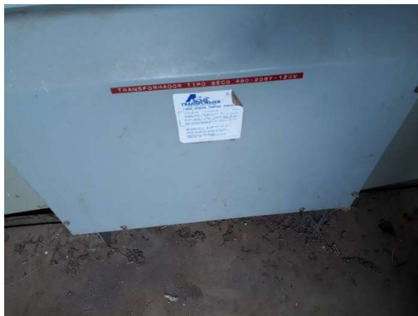
Figura 65. Transformador seco en cuarto de iluminación 2
