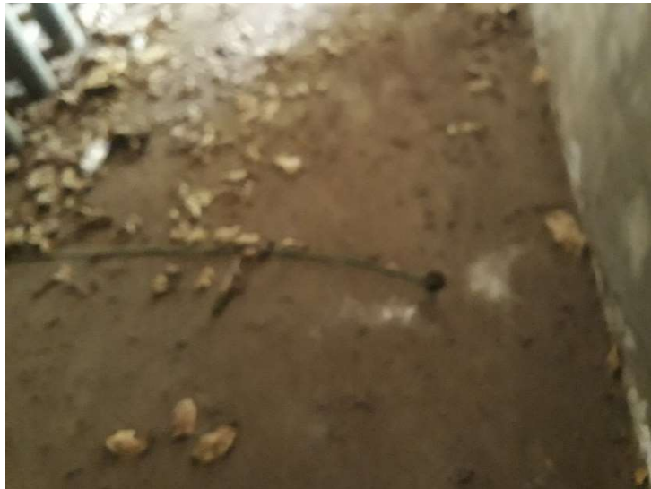
Figura 90. Varilla de cobre cuarto de potencia
