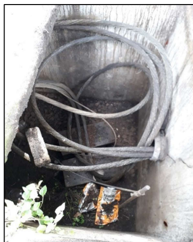
Figura 36. Condición actual de caja de registro y cable URD
