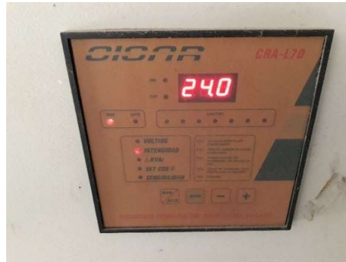
Figura 50. Módulo de compensación energía reactiva
