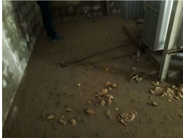
Figura 89. Varilla de cobre cuarto de potencia
