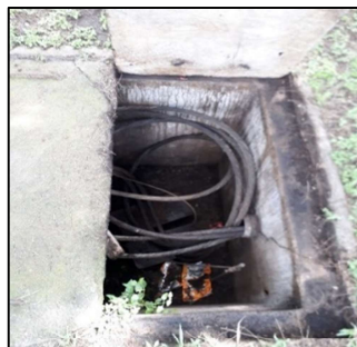
Figura 34. Cable de acometida subterránea
