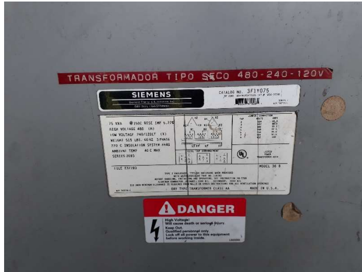
Figura 101. Transformador seco SIEMENS 75KVA
