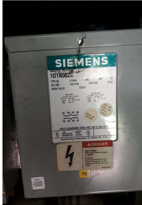
Figura 99. Transformador seco SIEMENS 2KVA
