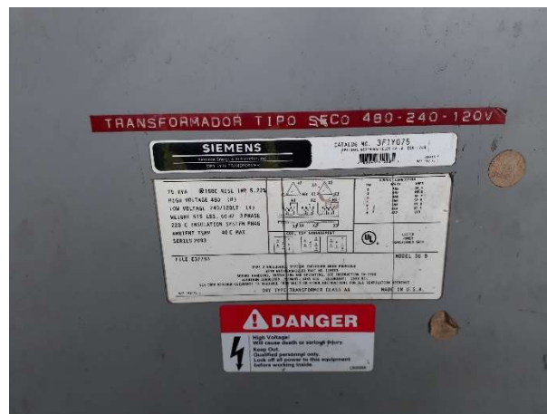
Figura 69. Transformador seco en cuarto de iluminación 3
