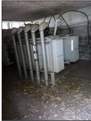
Figura 39. Cuarto eléctrico de potencia
