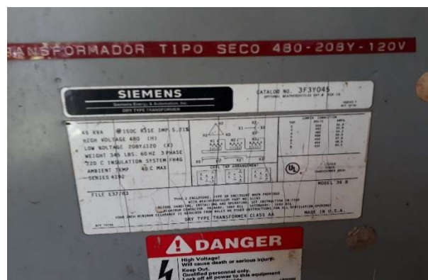
Figura 61. Transformador seco en cuarto de iluminación 1
