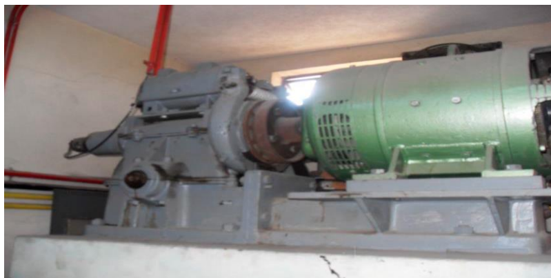
Figura 5. Cuarto de máquinas
