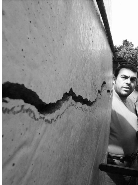
Figura 32. Colapso total por monofalla transversal única por esbeltez
