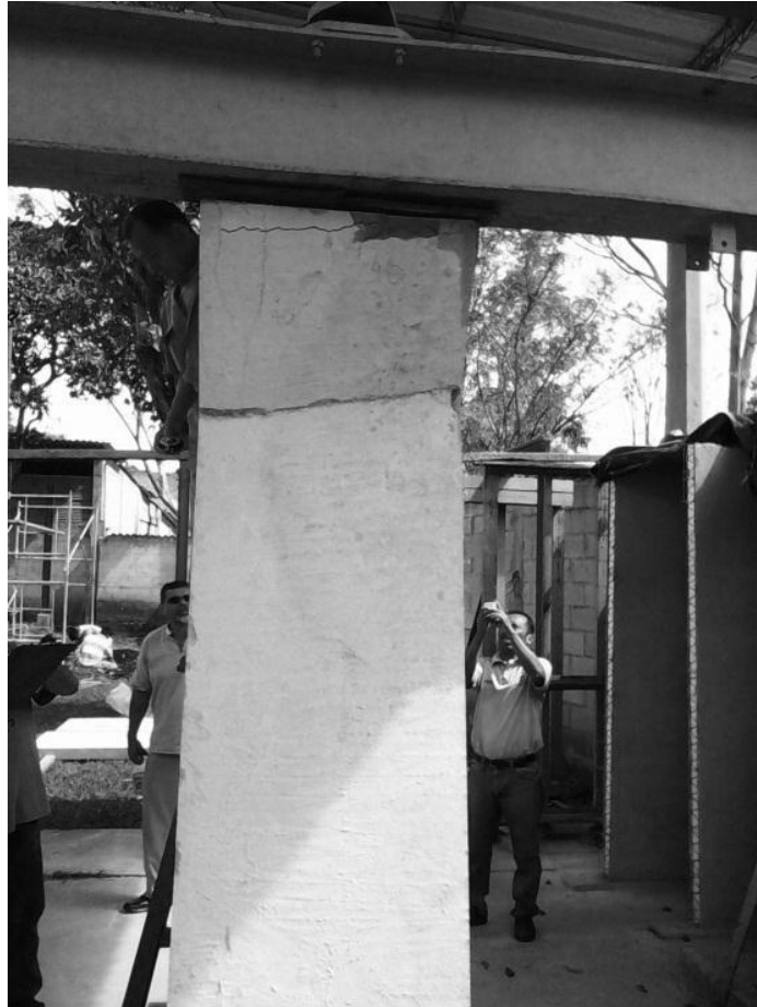
Figura 25. Aplastamiento total de esfuerzo último al punto de ruptura
