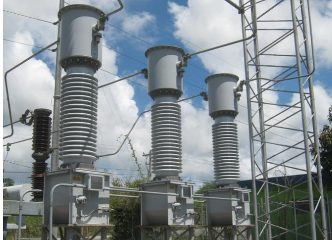
Figura 11. Unidades de medición Trench de 69 kV en subestación
