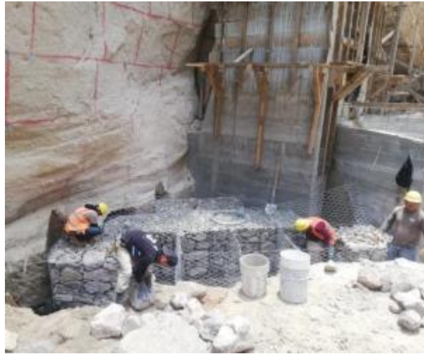
Figura 48. Gaviones en la descarga
