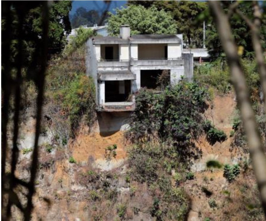
Figura 1. Erosión ocasionada por el mal manejo de aguas combinadas
