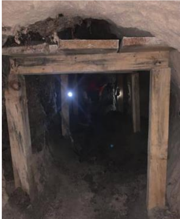
Figura 28. Entibado en zona de derrumbes
