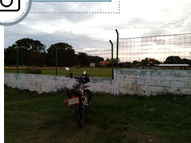
Figura 133. Cerramiento existen para el estadio municipal de Río Bravo, Suchitépéquez, en el se evidencia el deterioro por el uso. Fotografía propia, 2021
