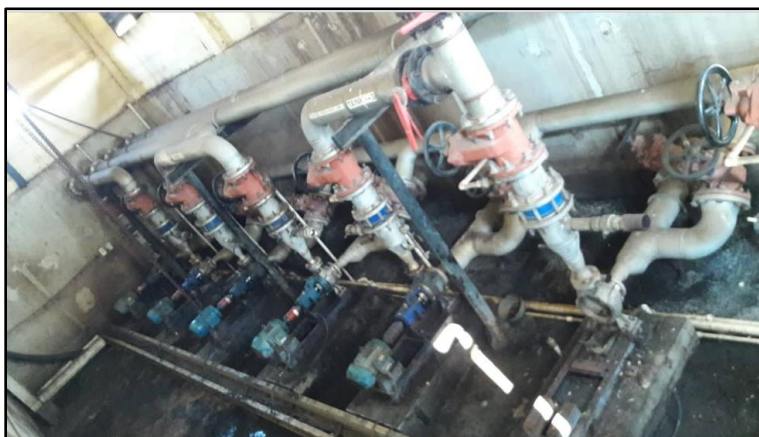
Figura No. 7. Tuberías que conecta las pilas de enfriamiento y los digestores.
