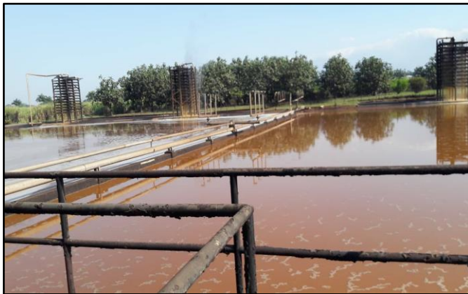
Figura No. 27. Pilas de enfriamiento.
