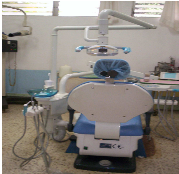
CLÍNICA DENTAL INSTALADA
