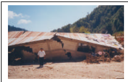
Foto 12. Destrucción de la Escuela Primaria de Panimaché III por Huracán Stan.
