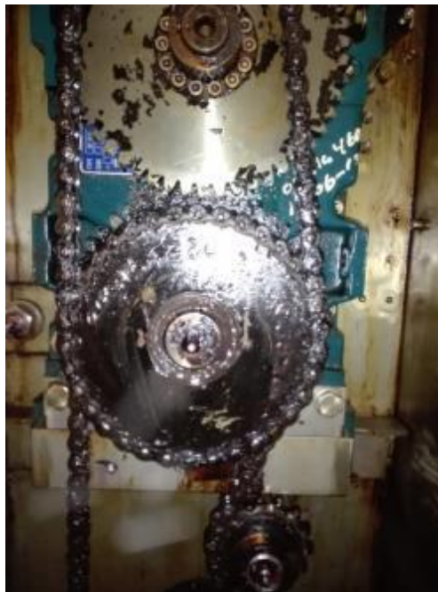
Figura 30. Condición de elementos en caja reductora
