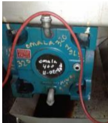
Figura 29. Fuga caja reductora
