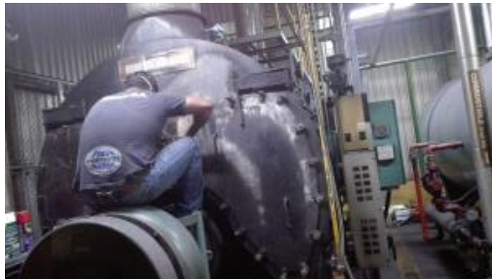
Figura 24. Mantenimiento calderas 300 BHP
