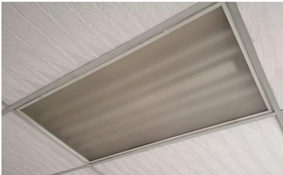
Figura 62. Luminarias de barras fluorescentes
