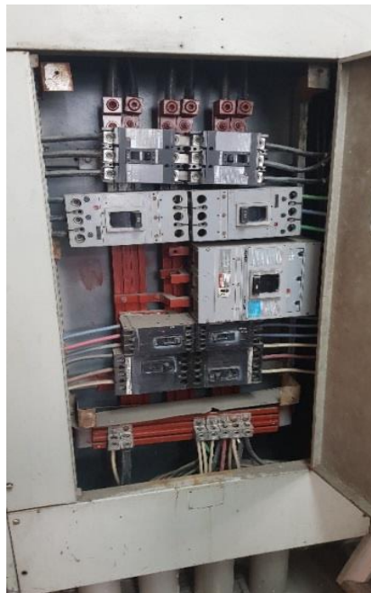
Figura 14. Tablero de distribución principal, Edificio A-B
