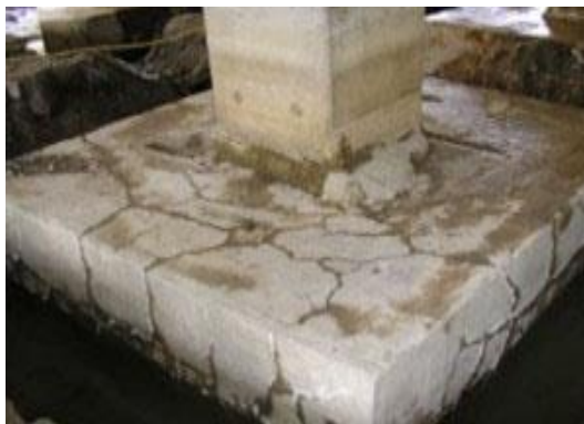
Figura 6. Imagen de pavimento dañado por reacción álcali-agregado
