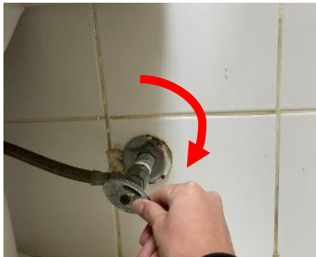
Figura 59. Llave de paso de agua potable
