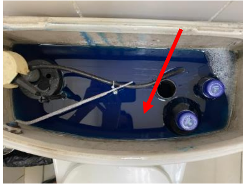
Figura 64. Chequeo del sistema de desinfección
