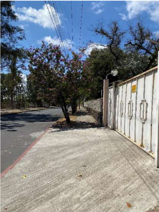
Figura 120. No.3 Estado actual de aceras sobre 20 avenida. Fuente propia.
