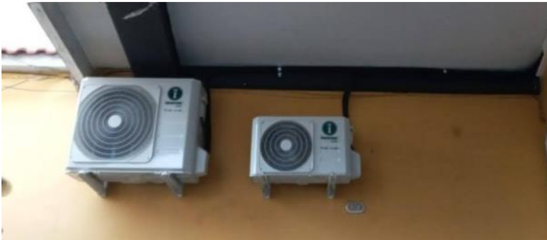
Figura 27. Equipos auxiliares para el aire acondicionado
