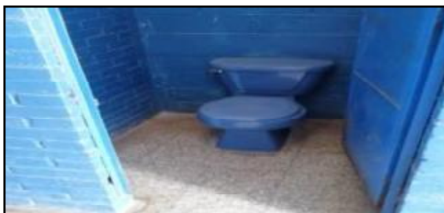
Figura 125. Fotografía de los inodoros
