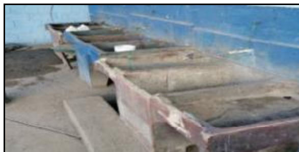
Figura 128. Fotografía de las pilas del área de servicio de limpieza
