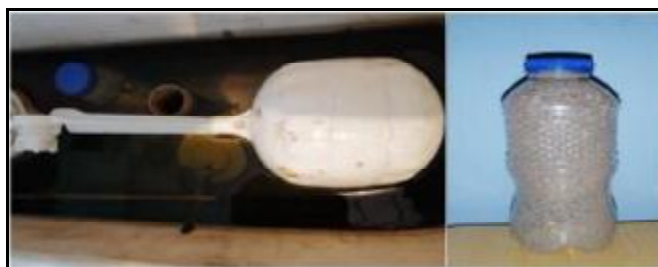
Figura 135. Fotografía de pachones de arena en tanque del inodoro
