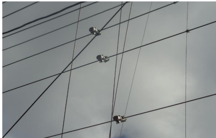
Figura 23. Equipos LineIQ en red de MT, CTO 150
