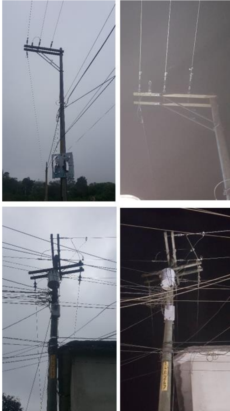
Figura 34. Traslado de carga para el circuito 150
