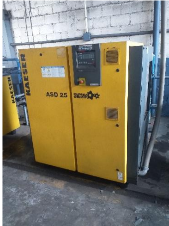
Figura 17. Compresor Kaeser ASD 25
