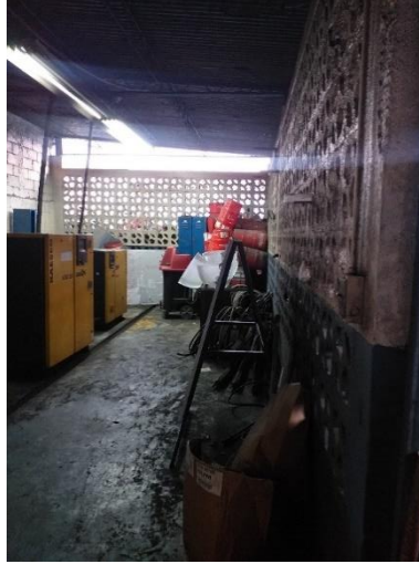
Figura 14. Cuarto de compresores
