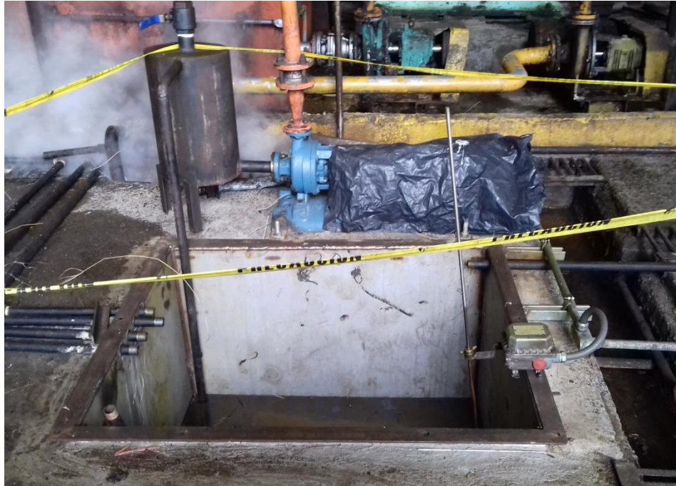
Figura 8. Tanque con bomba y medidor de nivel
