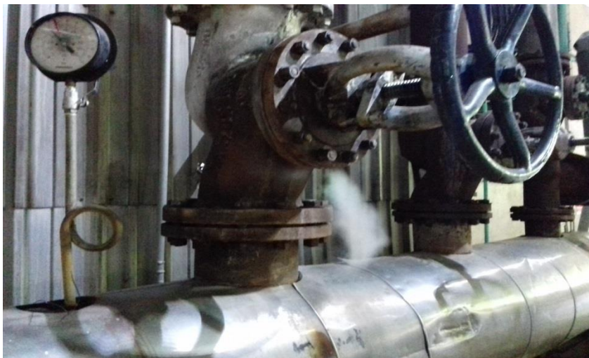
Figura 10. Fuga en junta de válvula, área de turbinas
