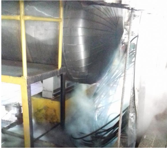
Figura 11. Fuga en tubería de condensados
