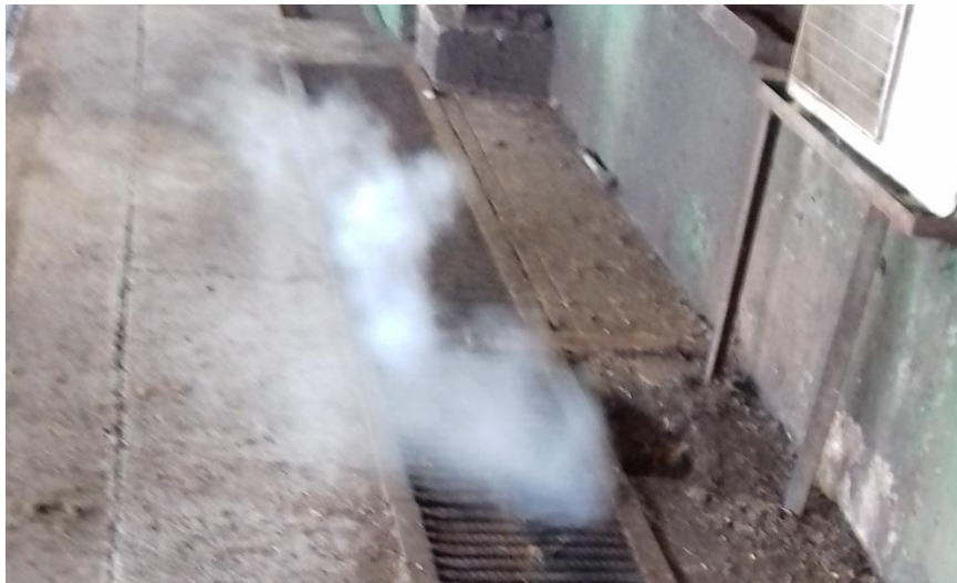
Figura 12. Fuga condensados esterilizadores
