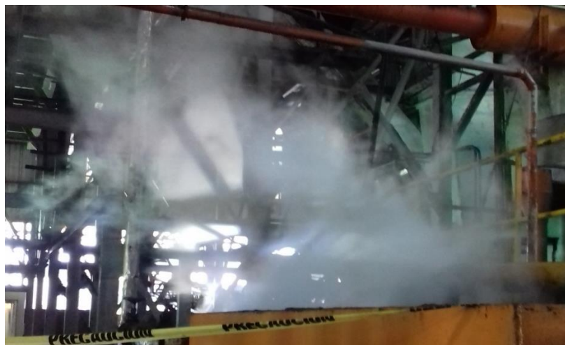
Figura 14. Vapor tanque recuperado de aceite
