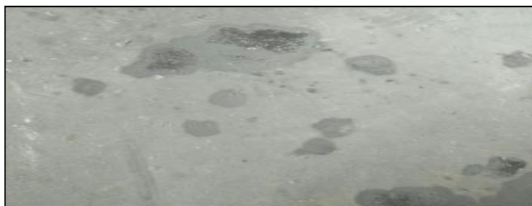
Figura 23. Riesgo de caídas
