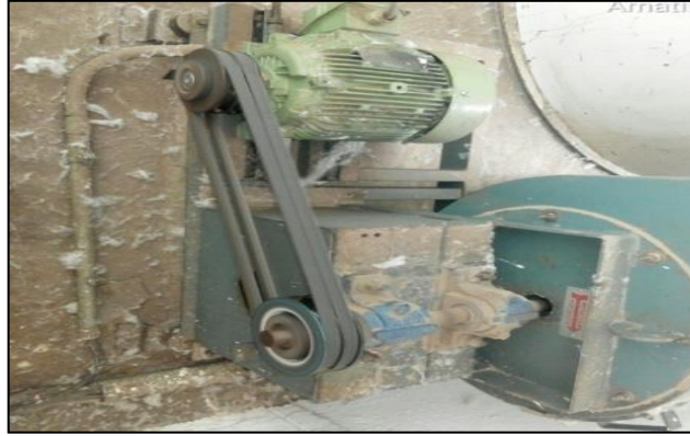
Figura 28. Falta de mantenimiento a equipos
