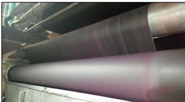
Figura 25. Riesgo de atrapamiento
