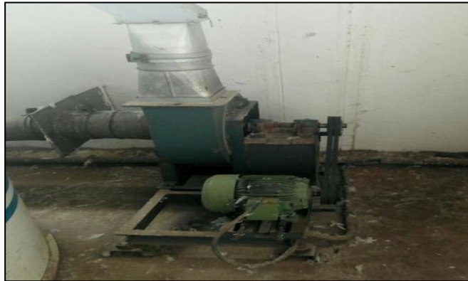
Figura 26. Falta de señalización y equipo en mal estado
