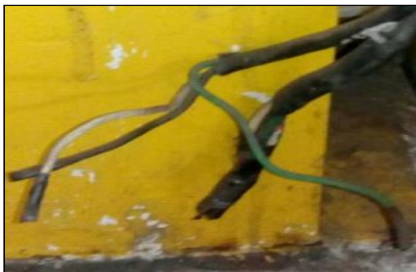
Figura 27. Uniones de cables eléctricos en mal estado
