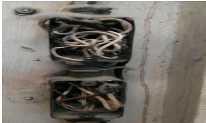
Figura 29. Toma corriente deteriorado
