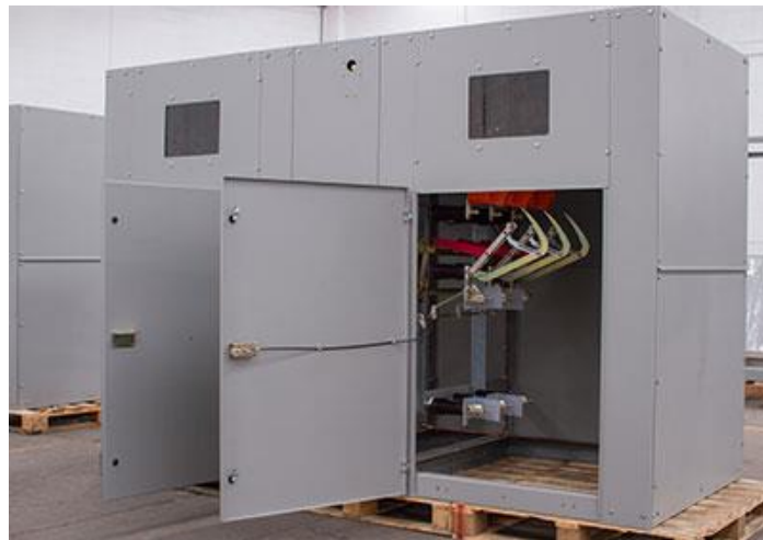
Figura 2. Subestación compacta aislada en aire
