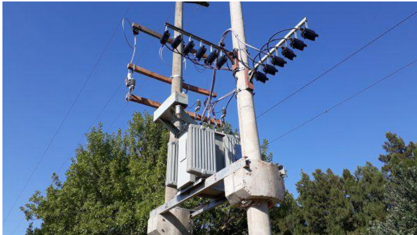
Figura 5. Subestación tipo aérea
