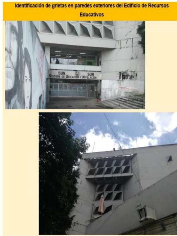
Figura 4. Identificación de grietas en paredes
