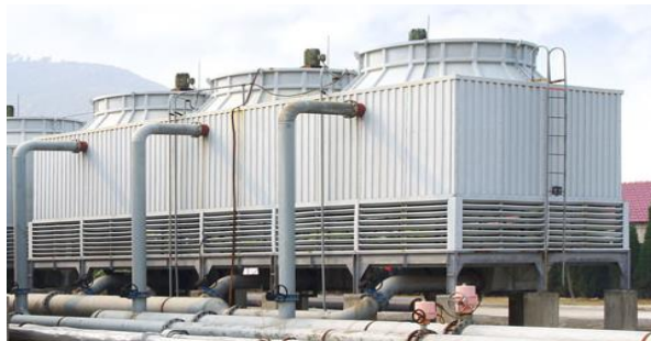
Figura 7. Torre de enfriamiento
