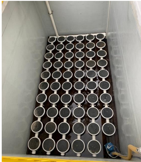
Figura 6. Digestor aerobio de disco
