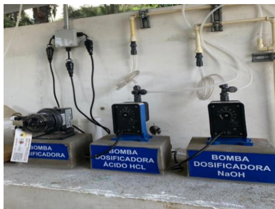
Figura 2. Bombas dosificadoras de NaOH y HCl
