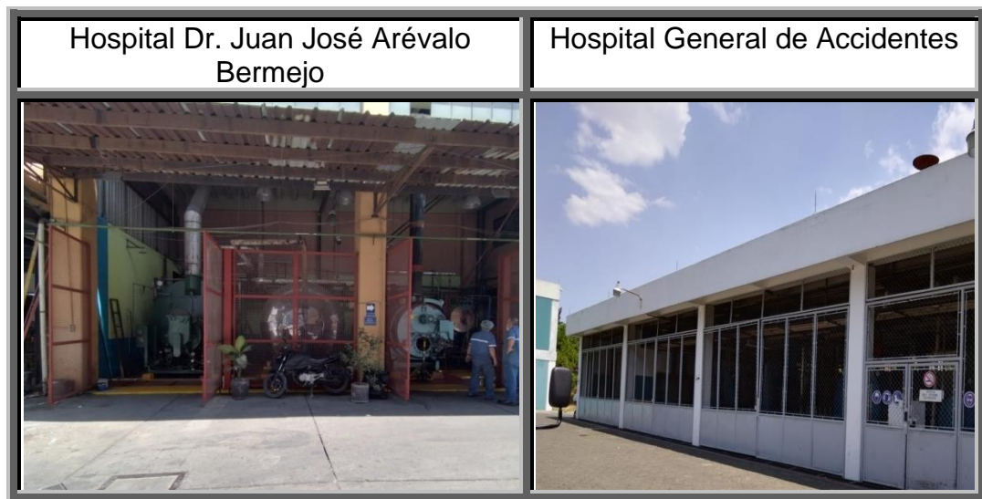
Figura 12. Área de Calderas
