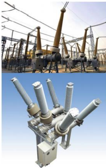
Figura 12. Interruptores de potencia de tanque muerto
