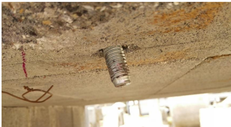
Figura 83. Efecto generado en perno de losa para anclaje de placas biela
