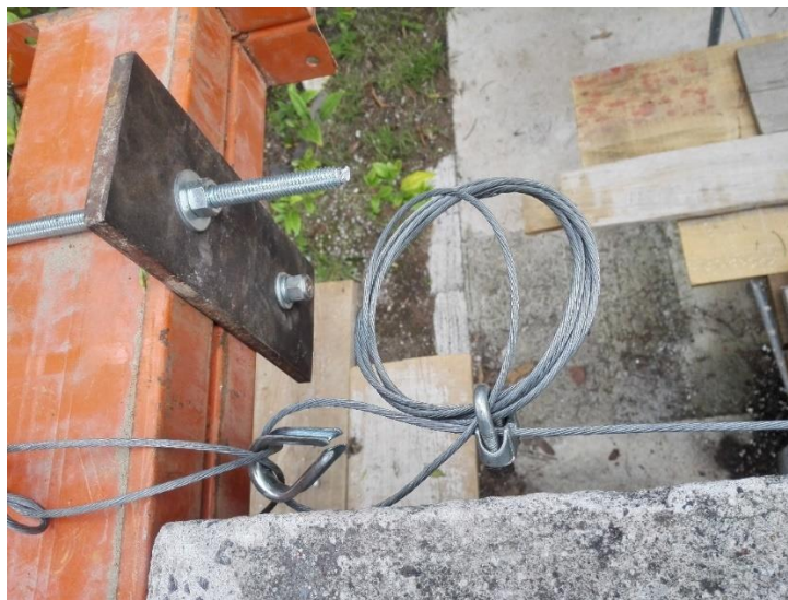
Figura 53. Cables de tensión que rodean el sistema
