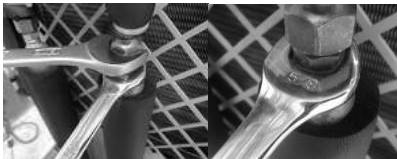
Figura 25. Utilización de herramienta para cambio de filtros
