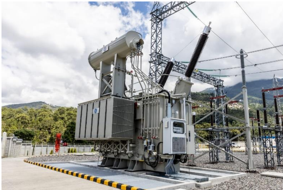
Figura 19. Reactor Multietapa en Derivación subestación Chiantla
