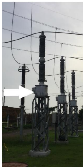
Figura 12. Transformador de potencial capacitivo
