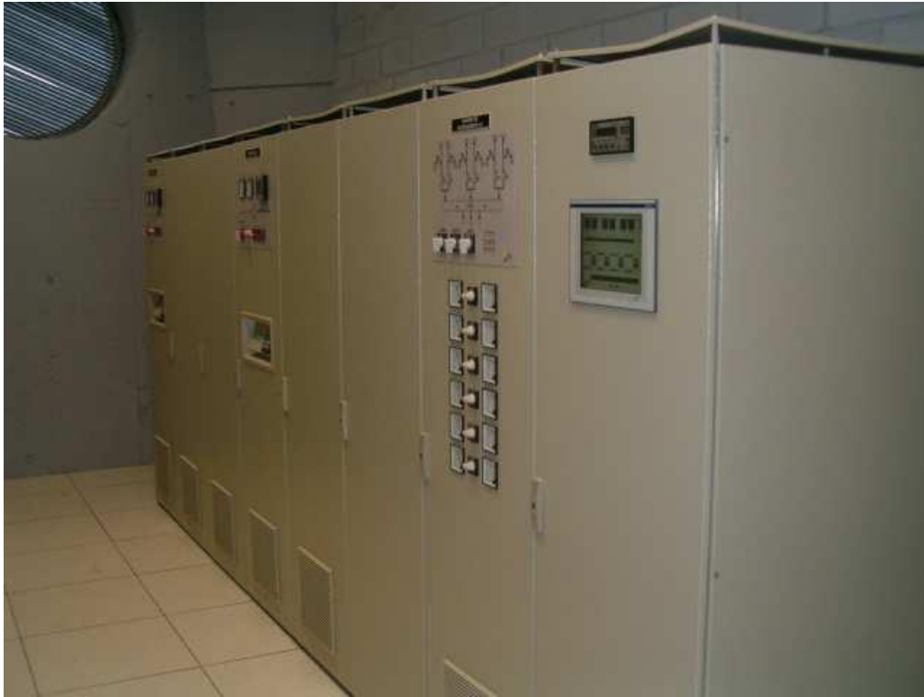
Figura 6. Cuarto de inversores
