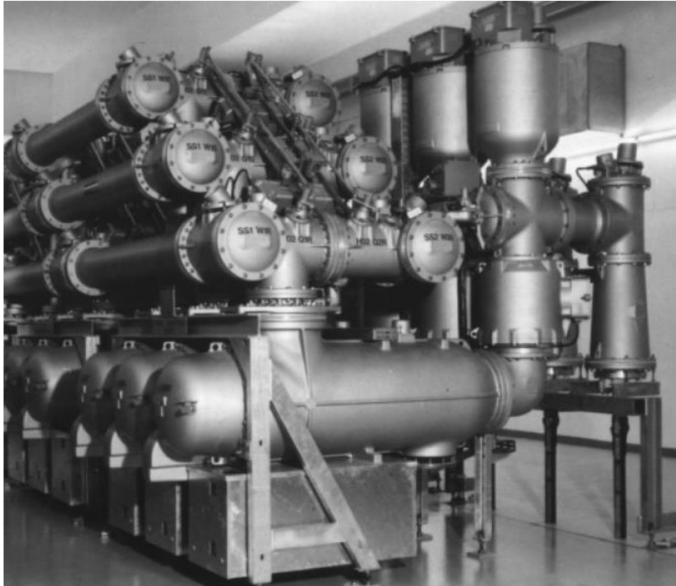
Figura 10. Subestación GIS antigua
