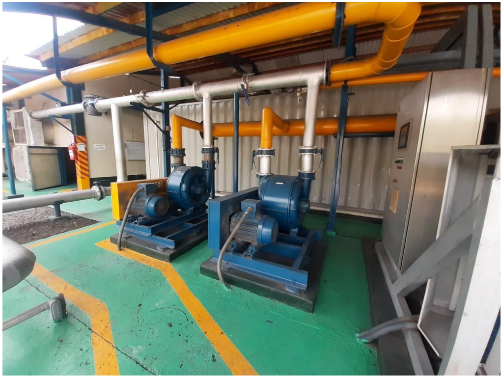
Figura 6. Sopladores de gas
