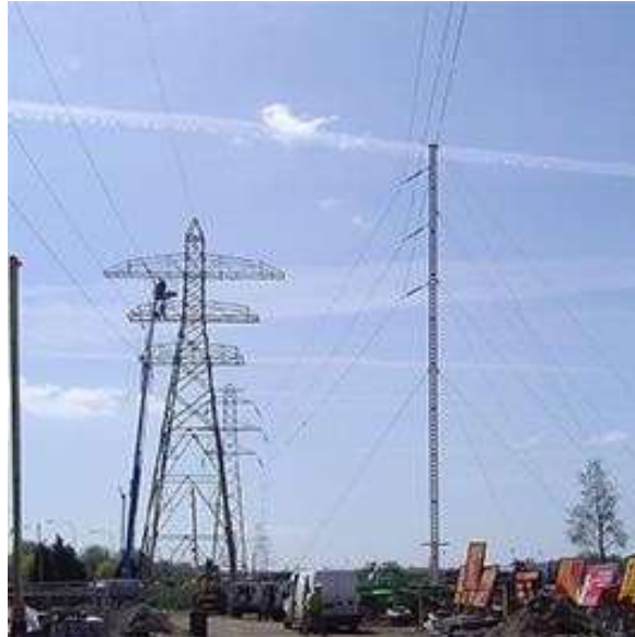
Figura 23. Torre de transmisión de emergencia
