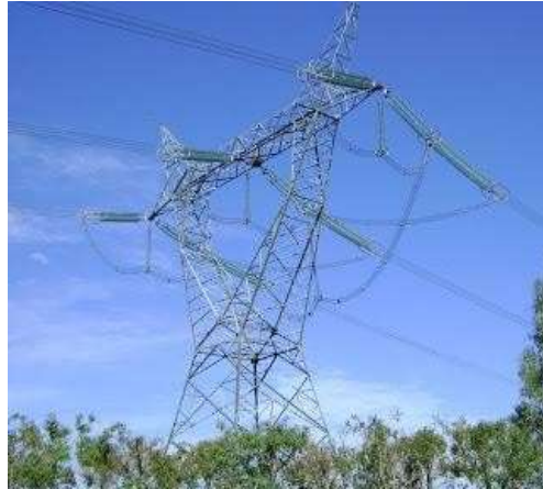
Figura 4. Torre de transposición
