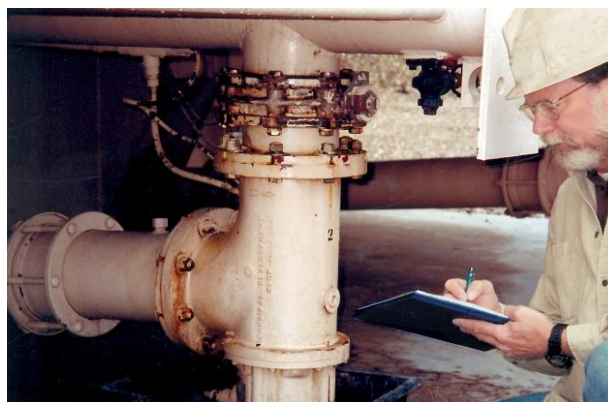
Figura 19. Fuga de aceite dieléctrico detectada en transformador
