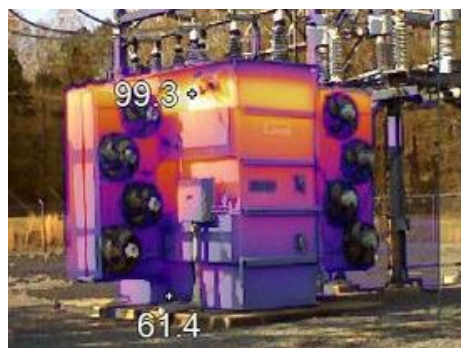
Figura 11. Termografía aplicada a un transformador de subestación
