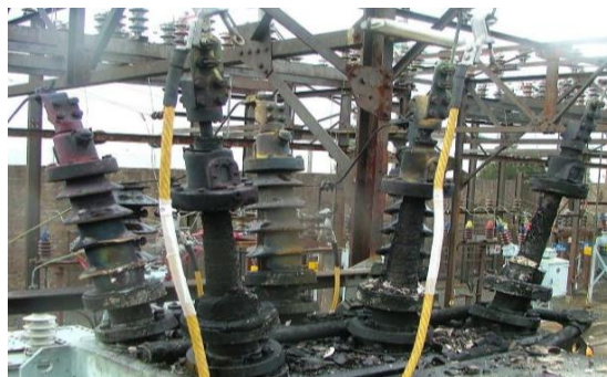
Figura 13. Falla en interruptor de potencia
