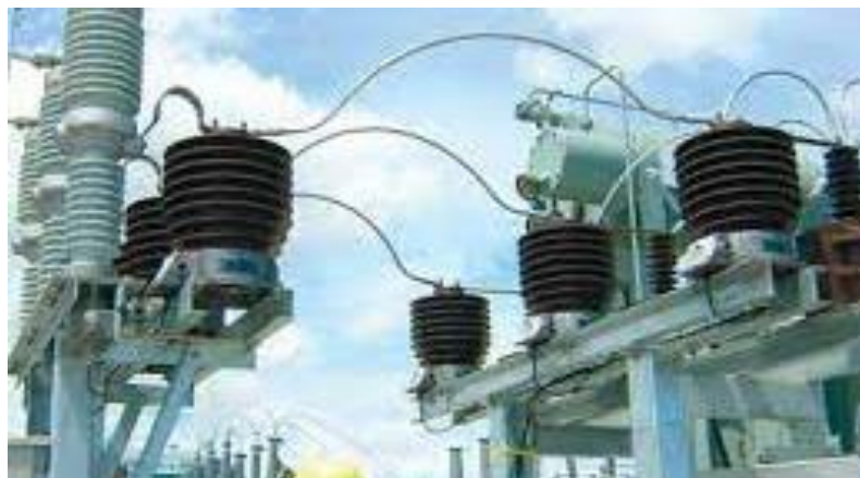
Figura 7. Transformadores de instrumento tipo subestación
