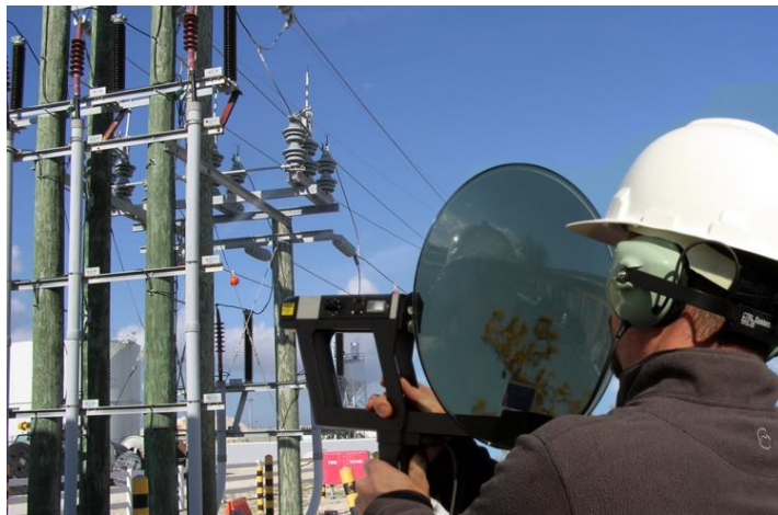
Figura 22. Inspección ultrasónica en subestación
