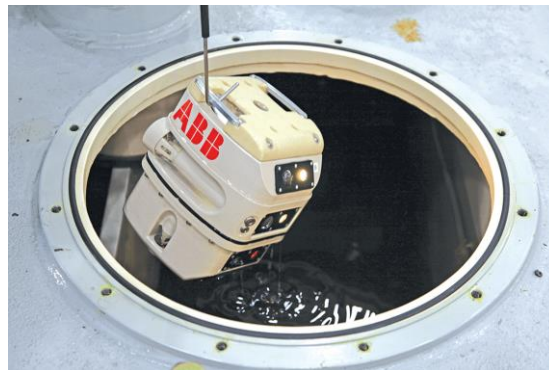
Figura 21. Boroscopio TXPLORE saliendo de transformador
