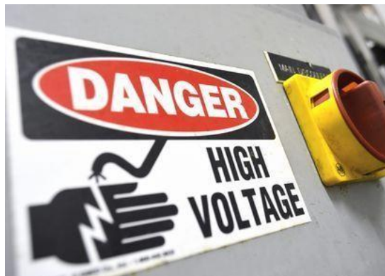
Figura 23. Rotulación sobre riesgos a la seguridad en subestaciones
