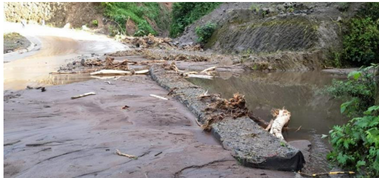
Figura 12. Caja de drenaje menor azolvada
