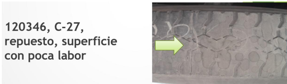
Figura 18. Agrietamiento y falta de labor
