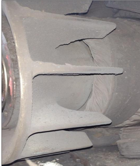
Figura 13. Ventilador desbalanceado por exceso de contaminación
