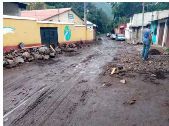
Figura 36. Daños causados en la avenida principal de San Juan Gascón por las lluvias
