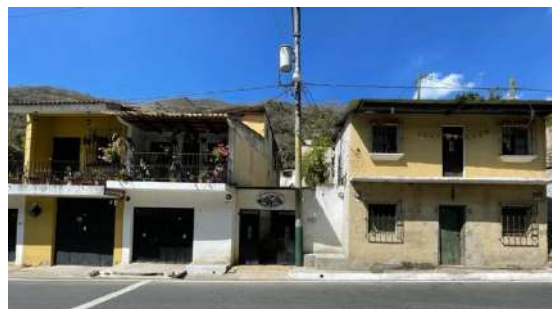
Figura 41. Poste eléctrico con transformador Fuente: Elaboración propia
